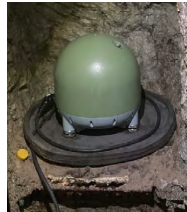
1- T360-GSN-Vault installé au fond de la mine de la station ECH (photo prise avant l'installation de la protection thermique).
