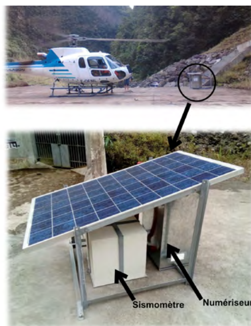
1 | Exemple d'installation pour la station RIV5.
