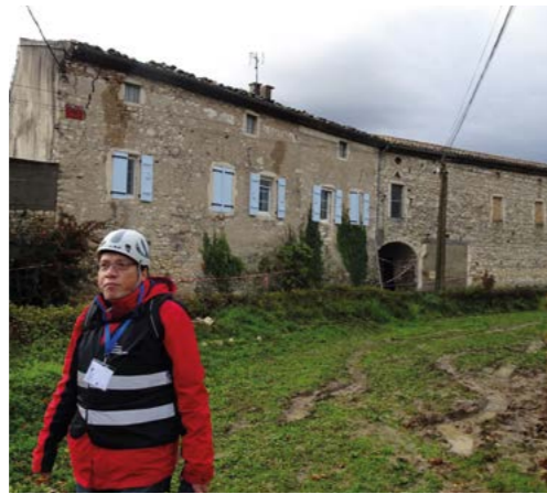
7 – Un expert du groupe d'enquête macrosismique devant un bâtiment endommagé par le séisme sur la commune du Teil. Photo : Marc Schaming (Eost)
