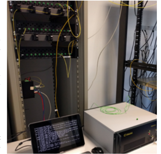
2 Photo du système DAS de Febus Optics durant une mesure sur le câble fond de mer MEUST-NumerEnv au large de Toulon
