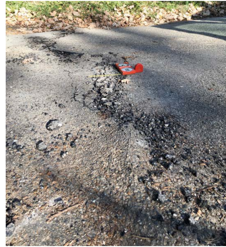
4 - Rupture de surface remarquable pour un séisme de magnitude 5, en France. L'ampleur du décalage est faible, de l'ordre de 2 cm. Coordonnées de l'observation sur la photo : 44.5307N - 4.6689E - élévation : 170 m. Photo : Jean-François Ritz
